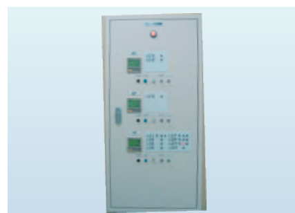
モニタ付制御盤
